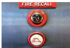
شکل ۶-۳۰- نمونه ای از کلید آتش نشانی
