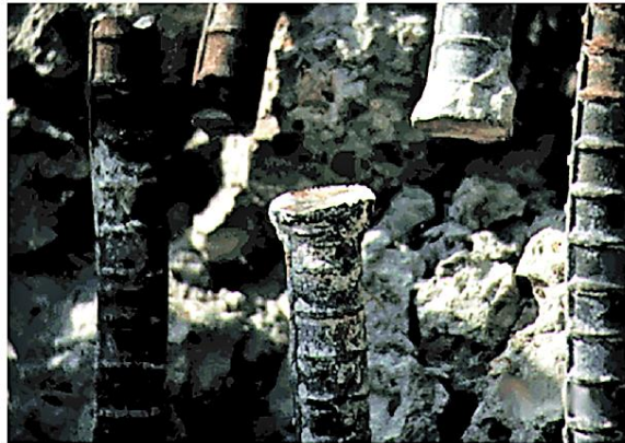
شکل ۳-۲: شکست وصله‌های فورجینگ در پل بزرگراهی هانشین - زلزله کوبه ۱۹۹۵
