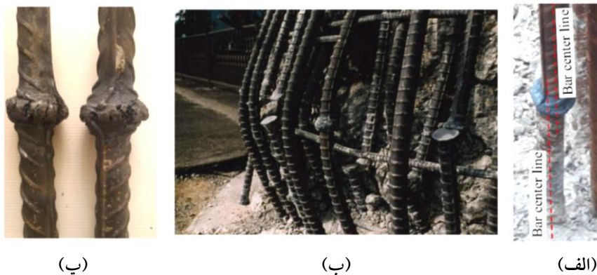
شکل ۳-۲۲: وصله جوش فورجینگ نامناسب: الف) خروج از محوریت غیر قابل قبول (ب) فشار ناکافی (پ) حرارت ناکافی (Dabiri et al., 2022)
