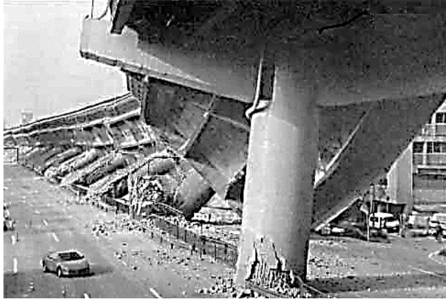
شکل ۳-۱: شکست بخشی از پل بزرگراهی هانشین در زلزله کوبه ۱۹۹۵
