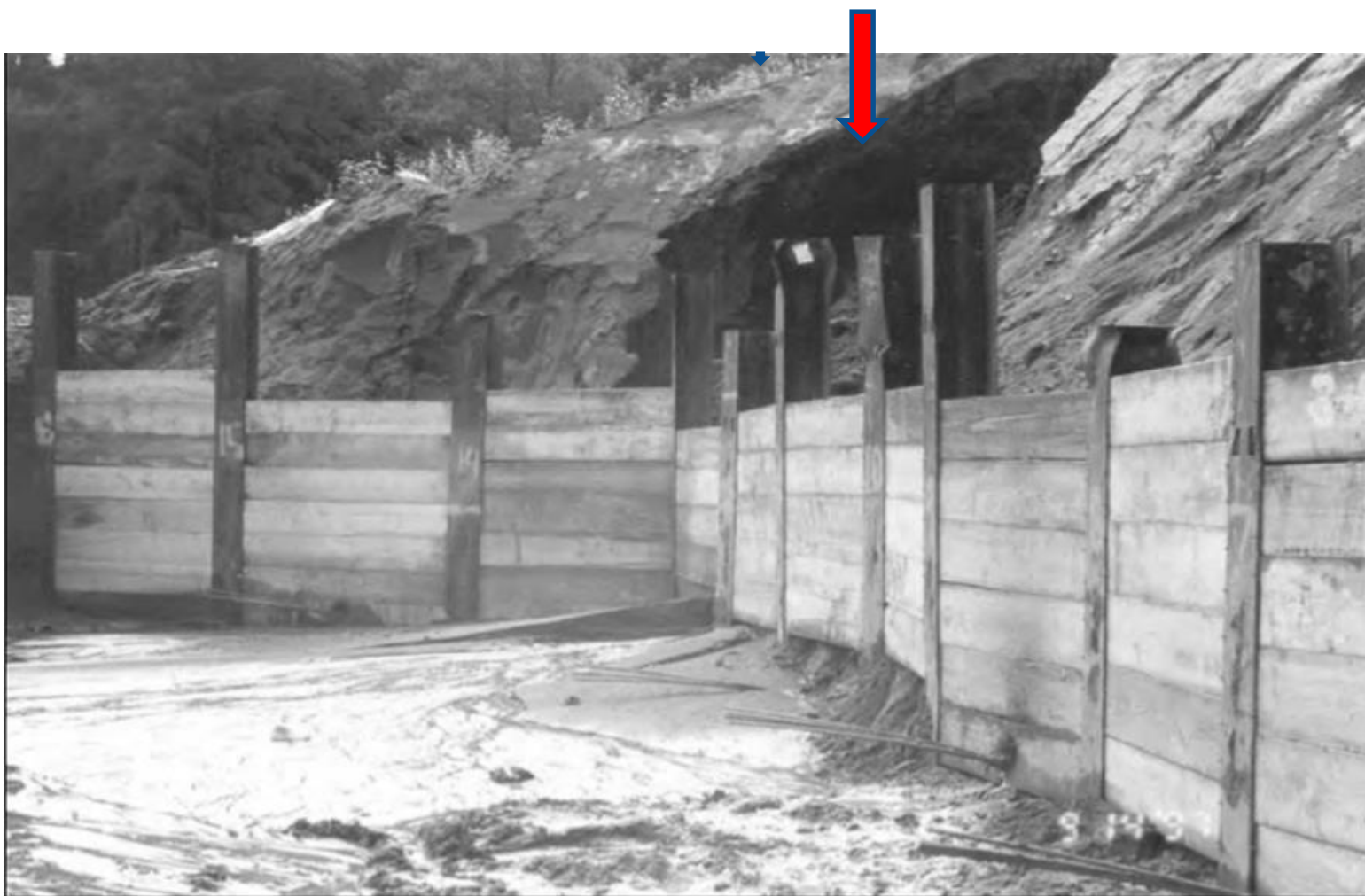
فرسایش شیب به دلیل عدم اجرای پوشش محافظتی
