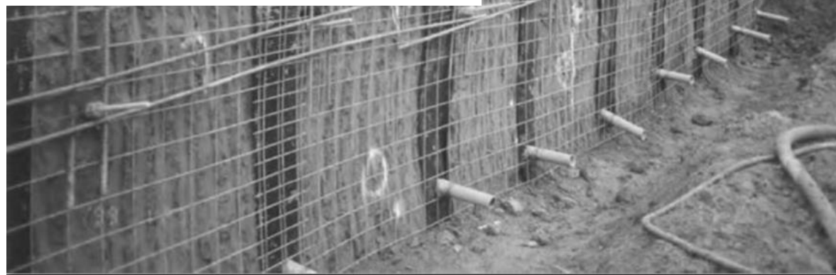
لوله‌های جمع‌آوری و هدایت آب‌های زهکشی شده
