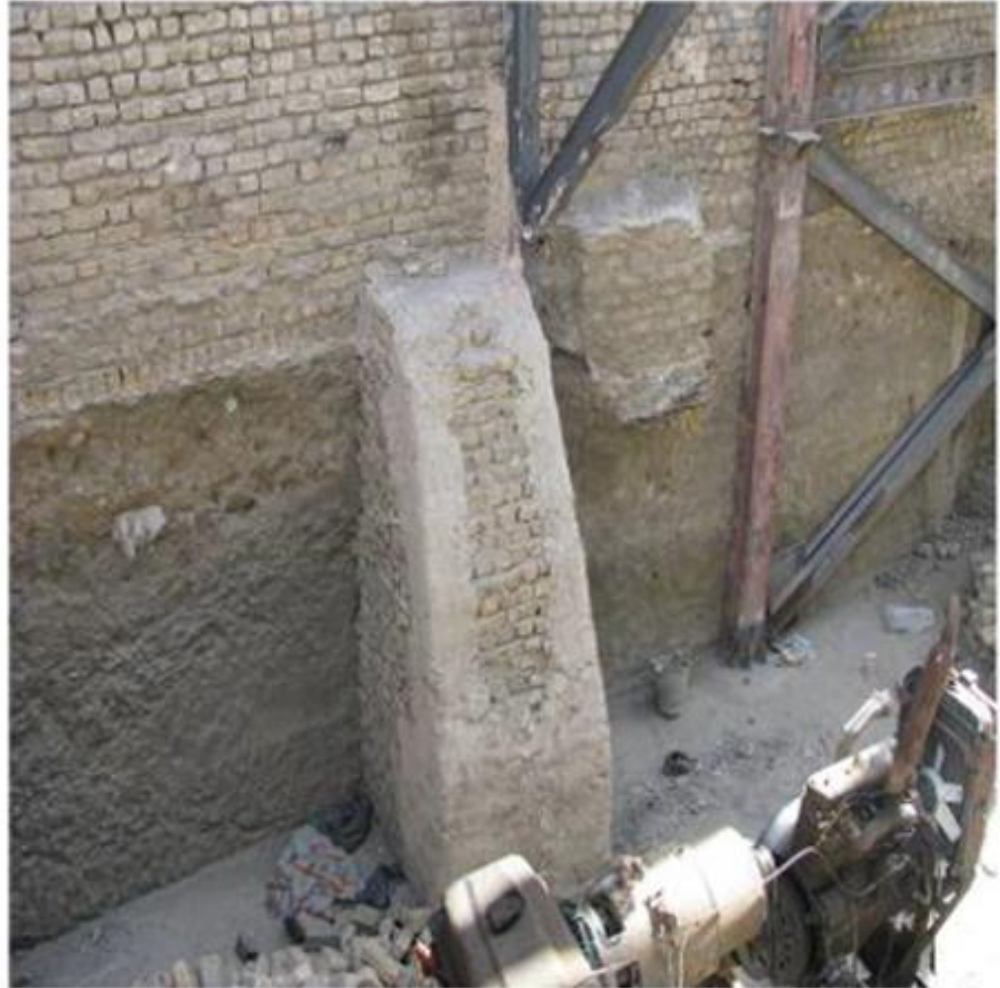
(ب) اجرای سازه نگهبان غیراصولی (منبری) و نشست ساختمان‌های مجاور
