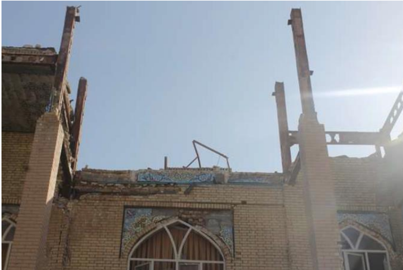
فروریزش سازه فولادی و سقف ورودی مصلی سرپل ذهاب
