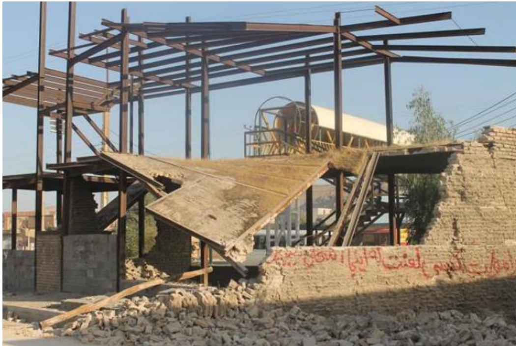
فروریزش بخشی از سازه فولادی در حال اجرا
