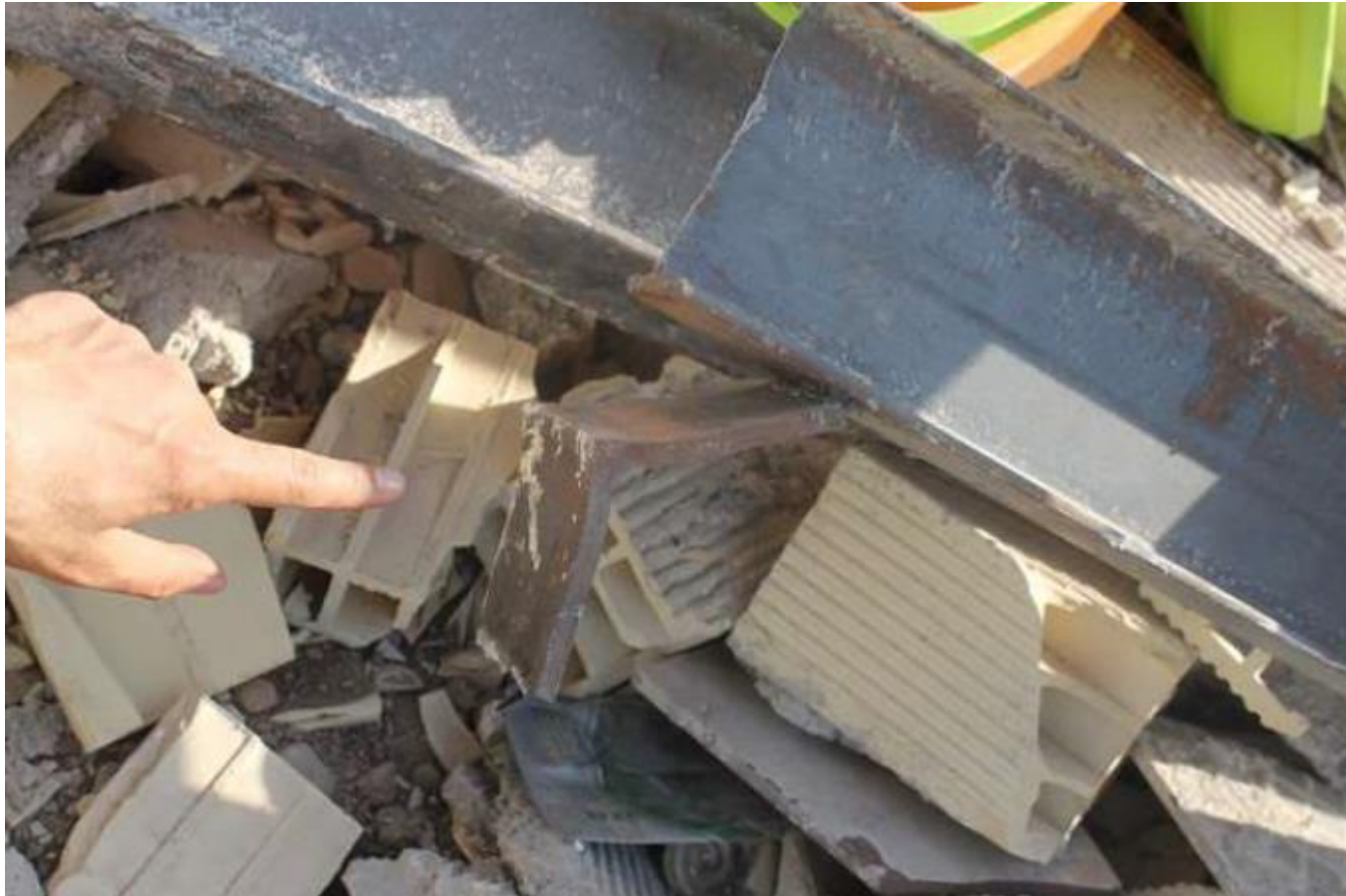
عدم نفوذ جوش گوشه اتصال نبشی به ستون
