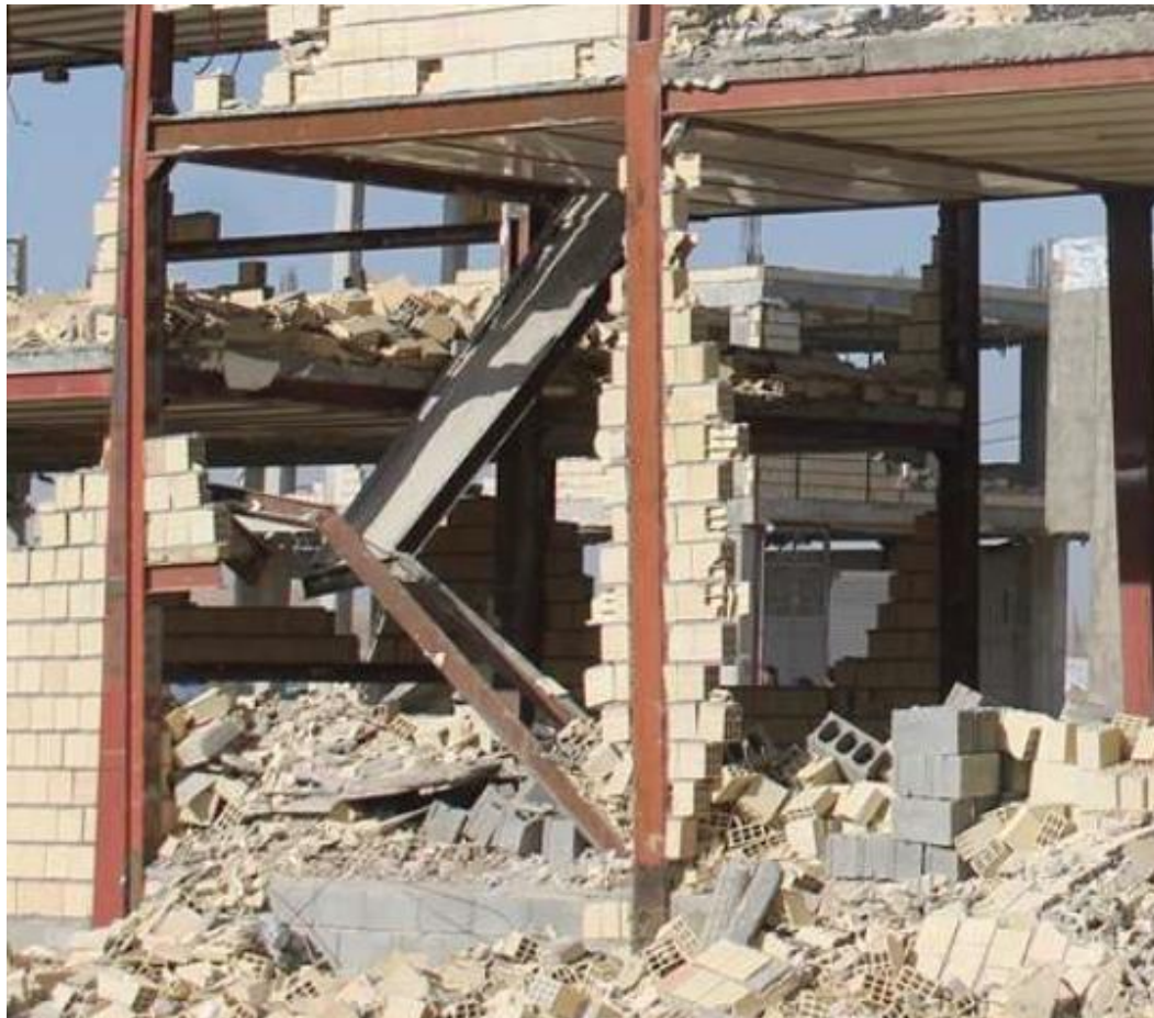
کنده شدن اتصالات تیرهای شمشیری راه پله
