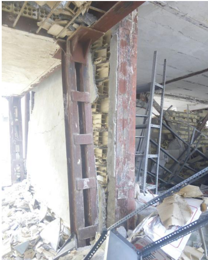
عدم استفاده از پلیت در زیر نبشی در محل اتصال تیر به ستون
