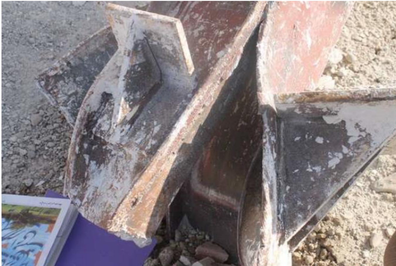
عدم جوش مناسب صفحه اتصال به ستون
