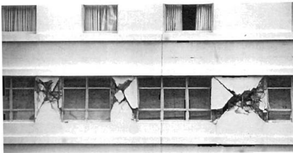
شکل ۲-۳۴- خرابی اجزای ستون و دیوار برشی کوتاه، زلزله نورتریج ۴ .
