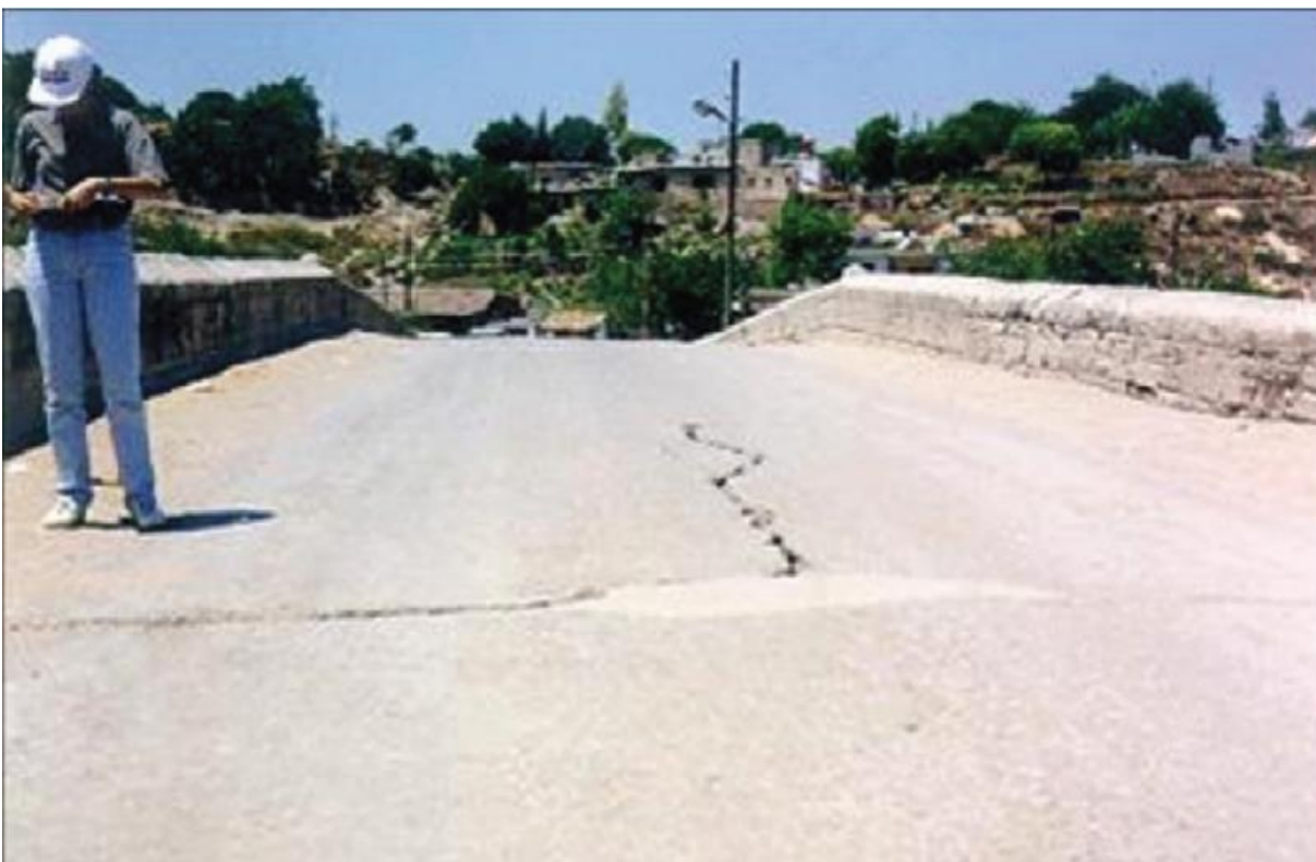
شکل ۲-۳۱- خسارت وارد آمده به پل میسیز در ترکیه در طول زلزله ۱۹۹۸ آدانا [۲۶]
