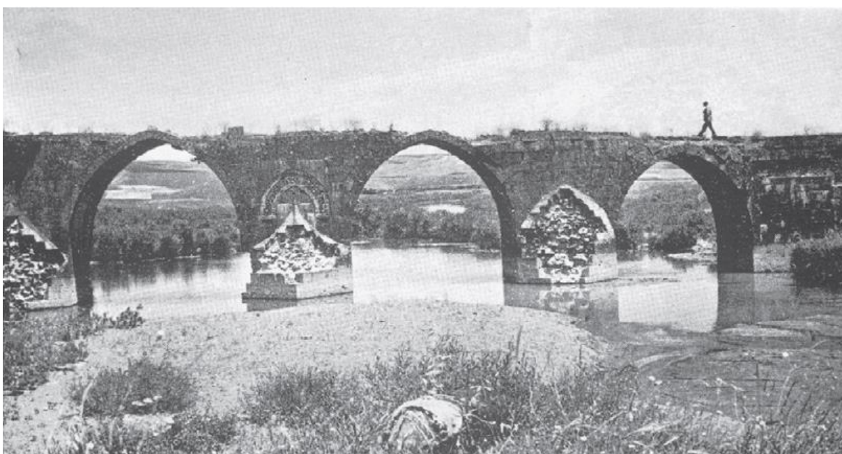
شکل ۲-۳۰- تخریب صورت گرفته در پایه ها که با جداشدن بخشی از قسمت های پایه همراه بوده در اثر وقوع سیل [۲۶]
