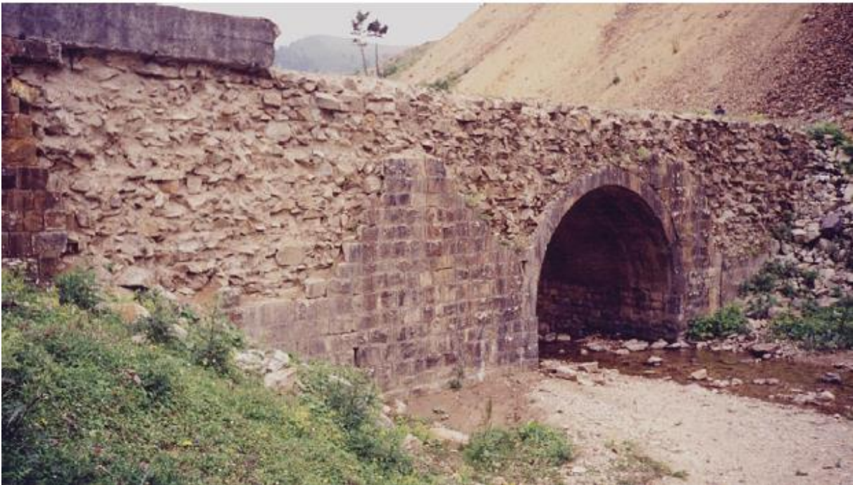
شکل ۲-۳۳- تخریب صورت گرفته در پل به دلیل ضعف در مشخصات مکانیکی مصالح استفاده شده در ساخت پل [۲۶]
