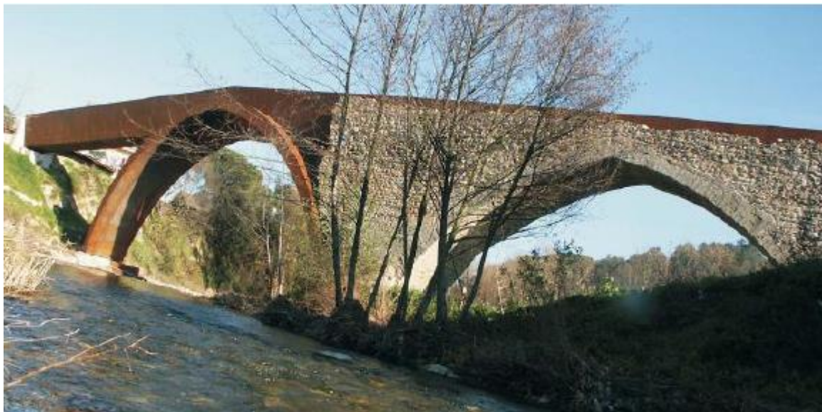
شکل ۲-۴- پل شکسته پس از بازسازی (روند بازسازی به گونه ای انجام شده که شکسته بودن پل معلوم باشد) [۱۰]
