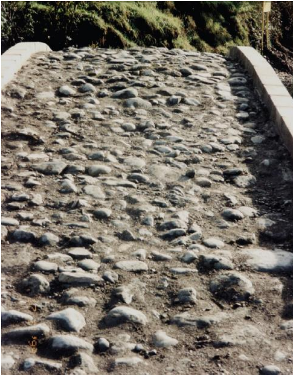
شکل ۲-۳۲- از بین رفتن پوشش روی پل در اثر آب باران و نداشتن زهکشی مناسب در پل سویزلی- ترکیه [۲۶]
