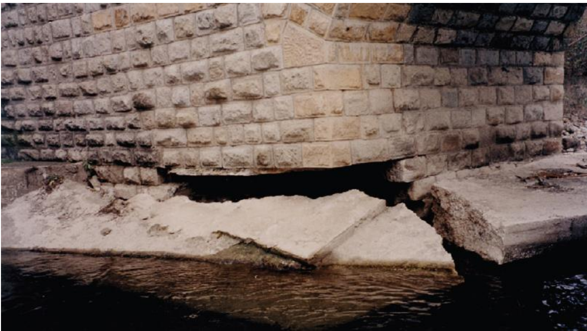
شکل ۲-۲۷- خرابی مشاهده شده در پل "متراسی" ناشی از نشست تکیه گاهی [۲۶]
